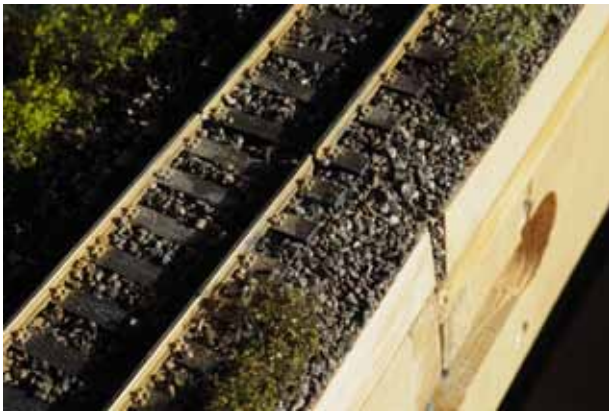
Nicht zufriedenstellende Modul / Segment-Verbindung
