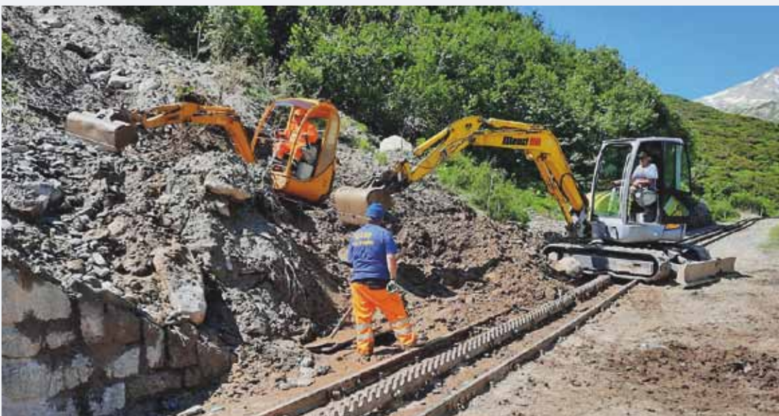
Beseitigung des losen Erdreiches, das abzurutschen droht und die Strecke erneut blockieren könnte.
